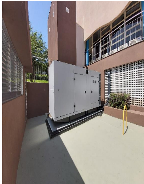
Prédio São José
